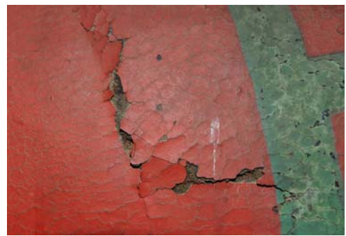
d. 채색층 균열로 인한 박락
