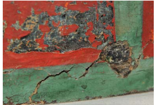
j. 표면층 균열로 인한 채색층 박락
