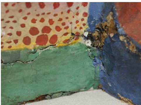
e. 표면층 균열
