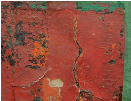
i. 표면층 균열
