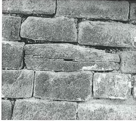
b. 균열, 박리현상
