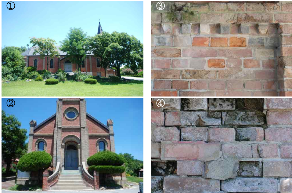
<그림 2> 주변의 수목 및 초본류(①, ②)와 당시대의 벽체의 풍화 및 균열(③, ④).
